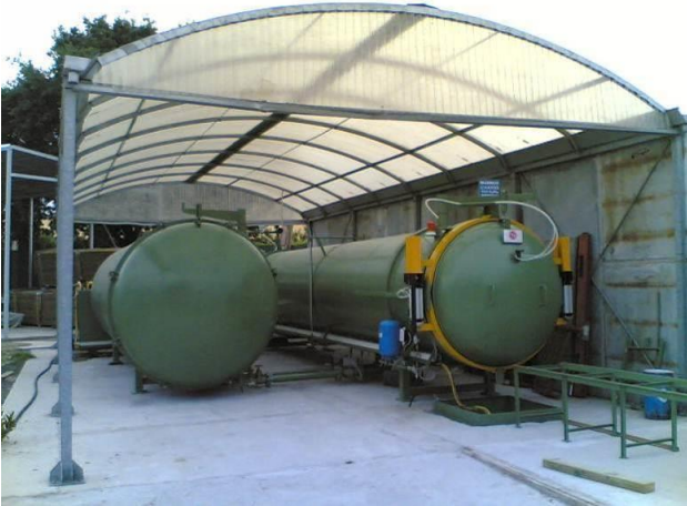
IMP-VPD con apertura laterale di 6m nelle Marche (Italia)
