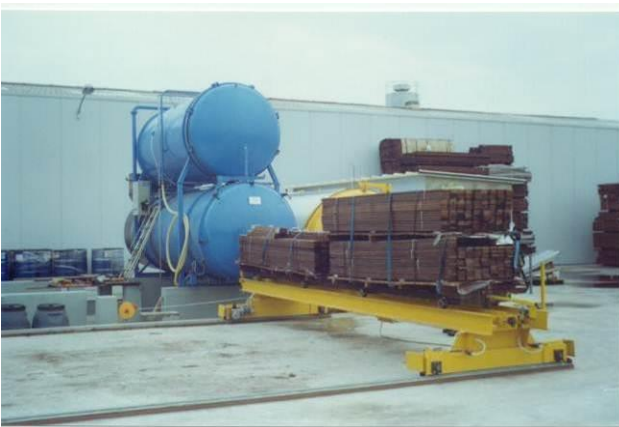
IMP-VPD con sistema motorizzato di carico e scarico a Barcelona (Spagna)
